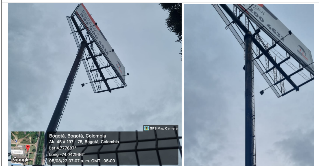
Foto 2 y 3. Vista de la estructura de la valla con corrosión, falta de mantenimiento y en mal estado.
